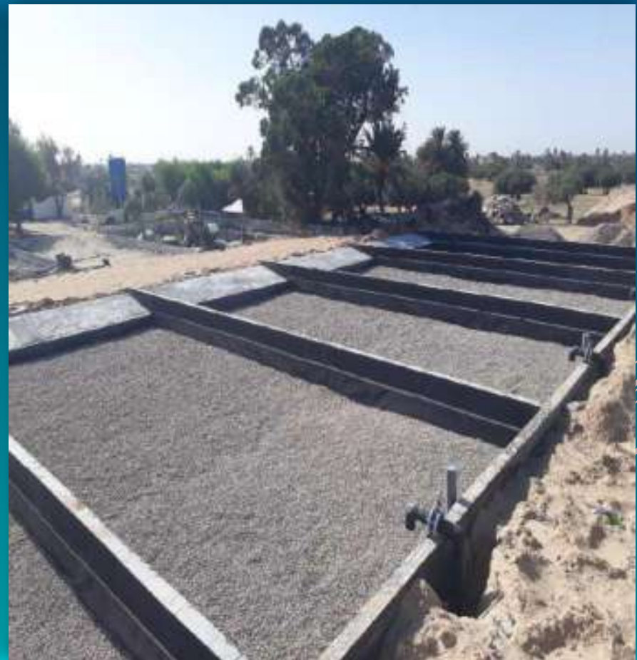
Extension des lits de séchage
