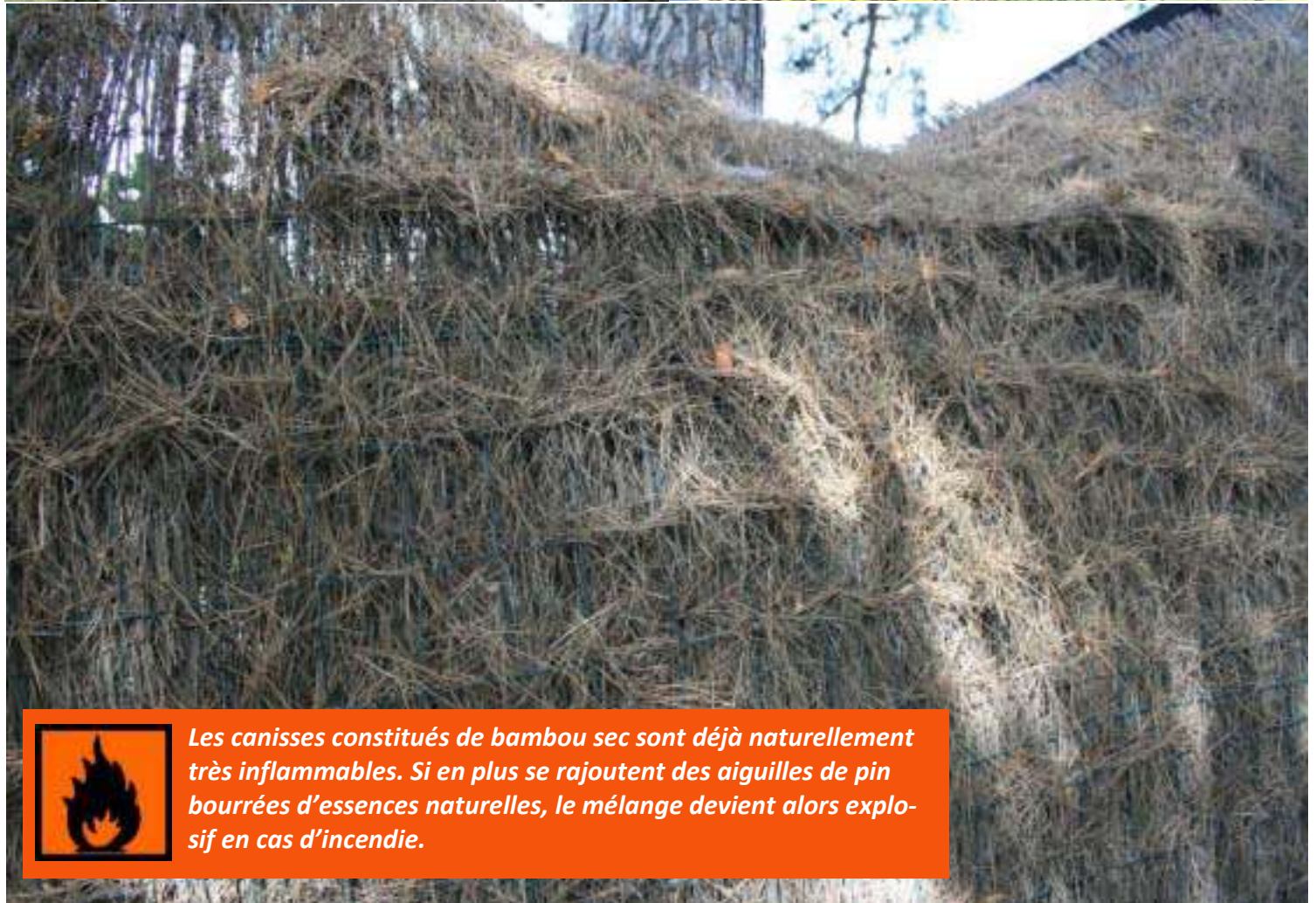
Les canisses, véritable ascenseur à incendie
